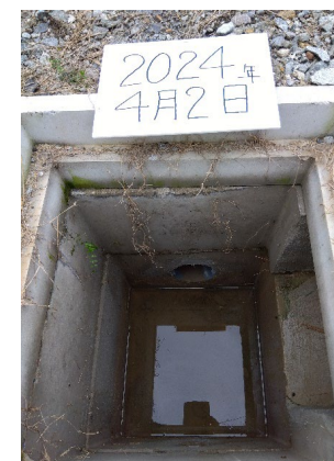
最終集水桝 (場内)
